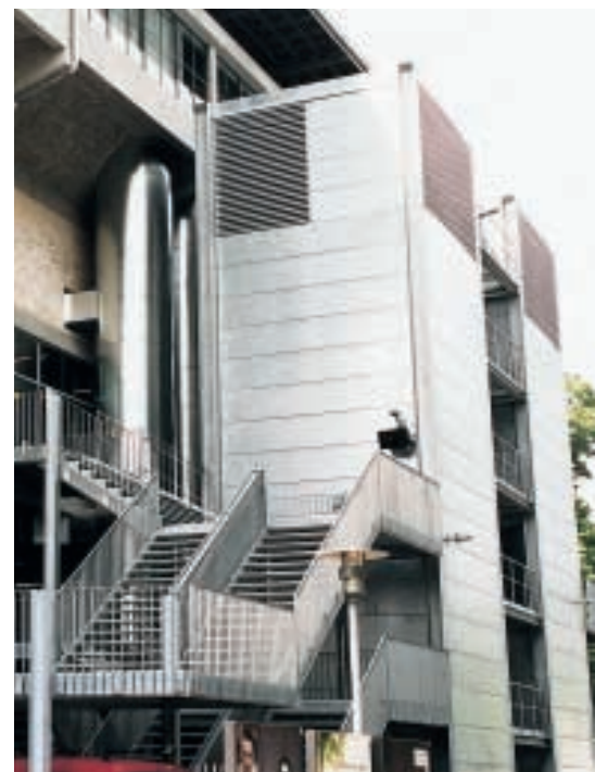
Die Lüftungsanlagen sind in vier vor der Fassade stehende 19 m hohe Türme eingebaut.
