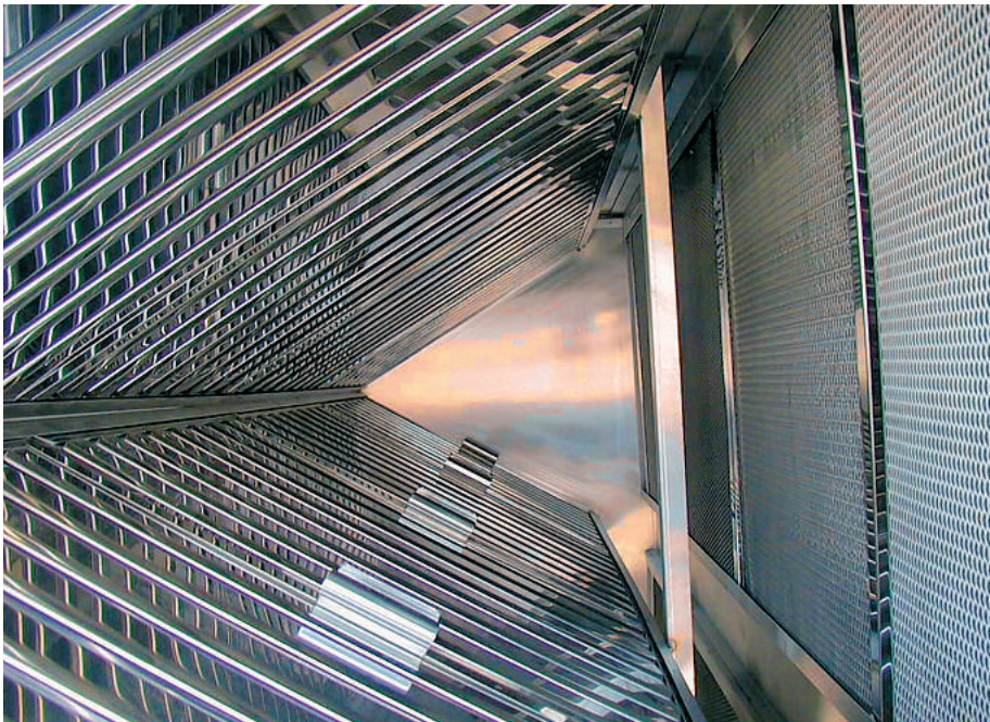
Bild 1: Hauptteil bei der Trennung von festen Teilen in der Abluft
