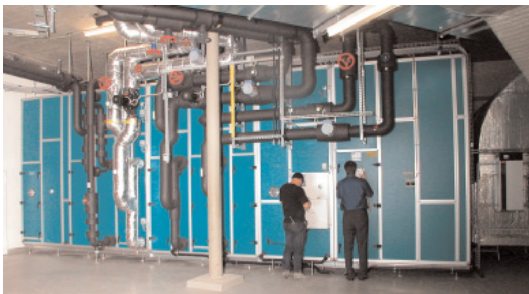
Zuluft-Monobloc von Weger mit einer Luftleistung von 100 000 m 3 /h. Zu- und Abluftgeräte wurden in Einzelteilen (22 Paletten) angeliefert und in der Zentrale erstmals montiert.
