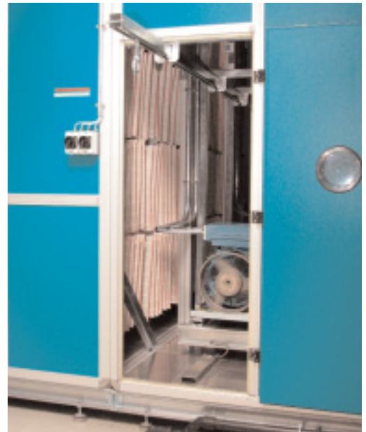
Interessante Details: Kranbahn mit Laufkatze für vereinfachten Ausbau der Motoren. Die Abläufe der Kondensatwannen mit Gefälle sind frontseitig.
