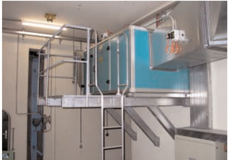
Anordnung der Monoblocs in einer der fünf Lüftungszentralen.
